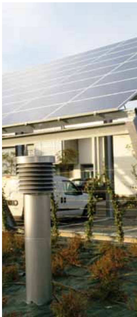
Impianto solare fotovoltaico su pensilina, Comune di Conselice (RA)
