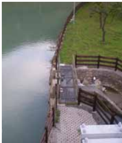
Impianto di risalita dei pesci della centrale idroelettrica "Claudio Castellani" nella Bassa Valle Isarco
