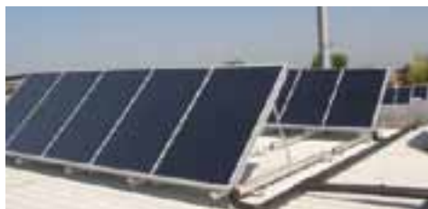
Impianto solare termico, Comune di Bra (CN)
