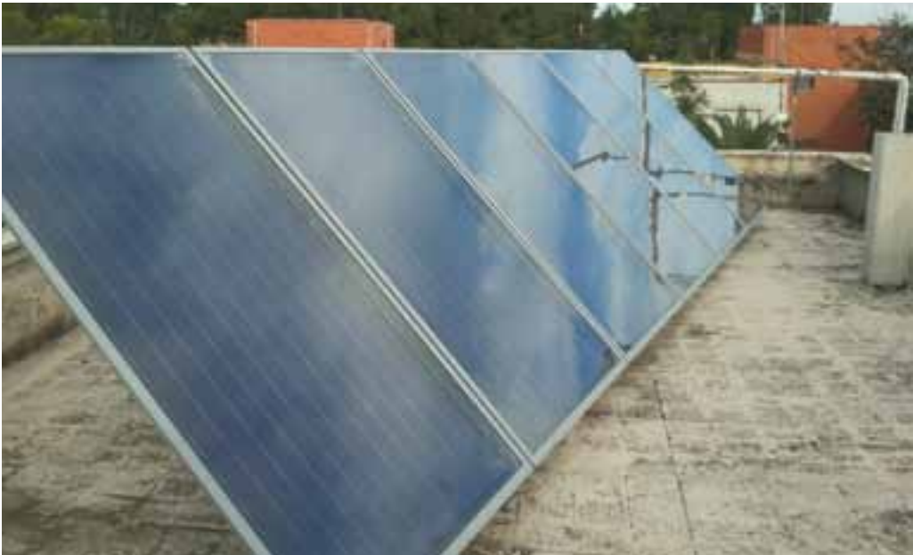
Impianto solare della Comunità di accoglienza Emmaus, Comune di Foggia
