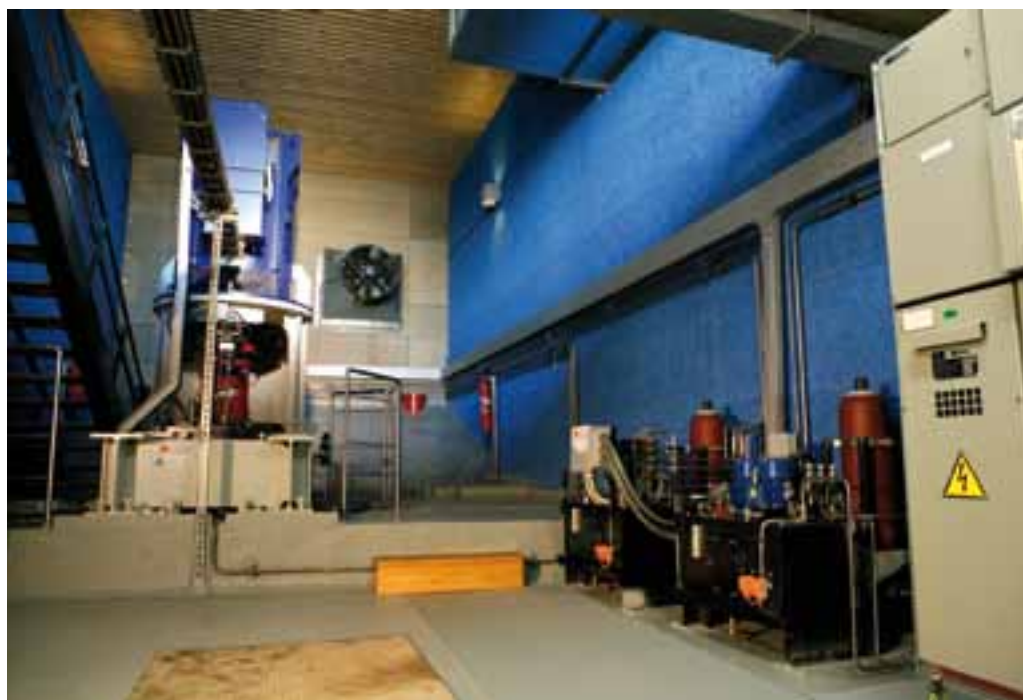
Impianto idroelettrico Envirometal Park (TO)
