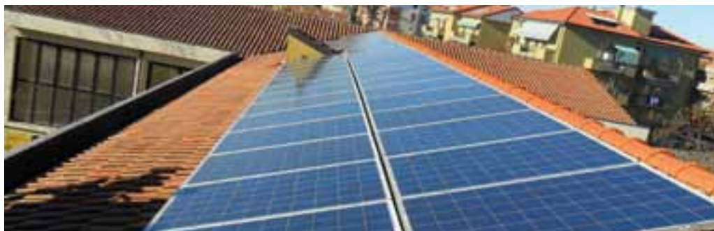
Impianto fotovoltaico scuola Due Giugno, Comune di Piacenza
