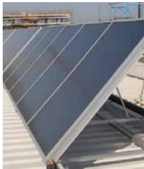
Impianto solare termico, Comune di Bra (CN)
