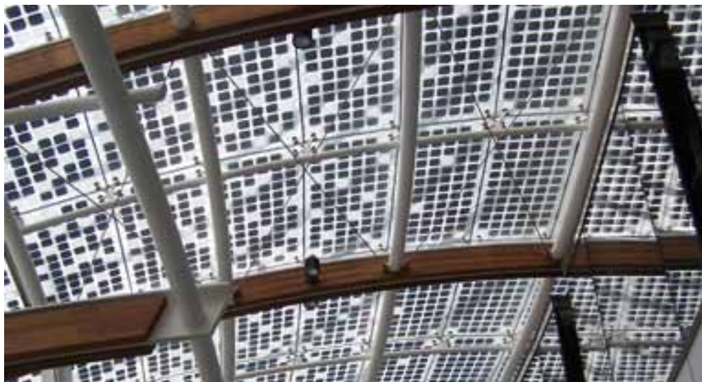
Impianto fotovoltaico integrato nella copertura, piazza Porta Nuova, Comune di Milano
