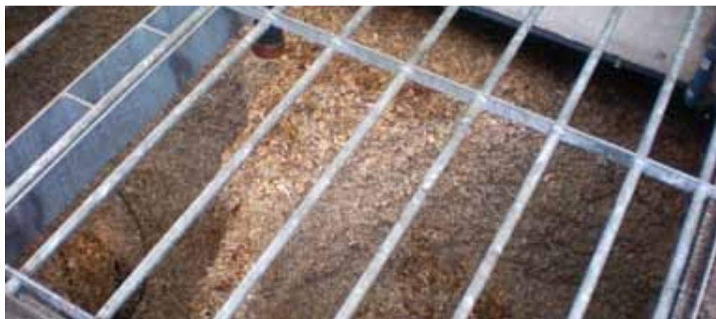
Vasca di raccoglimento del cippato del piccolo impianto a biomassa a Caldaro sulla Strada del Vino (BZ)
