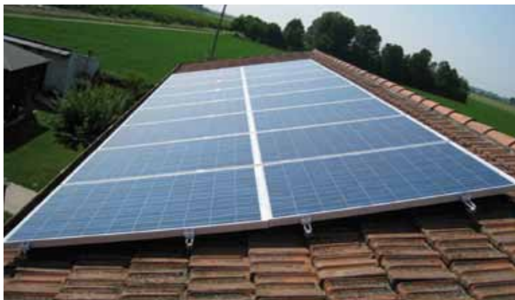
Impianto fotovoltaico su tetto, Comune di Alfonsine (RA)
