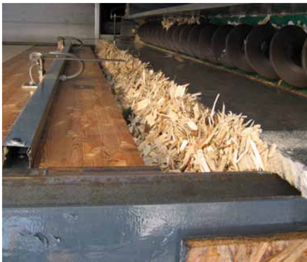
Impianto per lo sminuzzamento della biomassa solida
