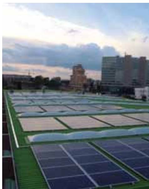
Impianto fotovoltaico su edificio pubblico, Comune di Bari
