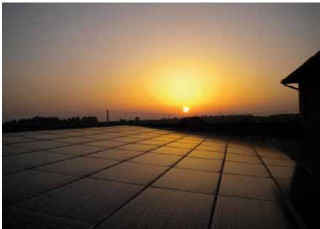
Impianto fotovoltaico Tenuta Menfi (AG)
