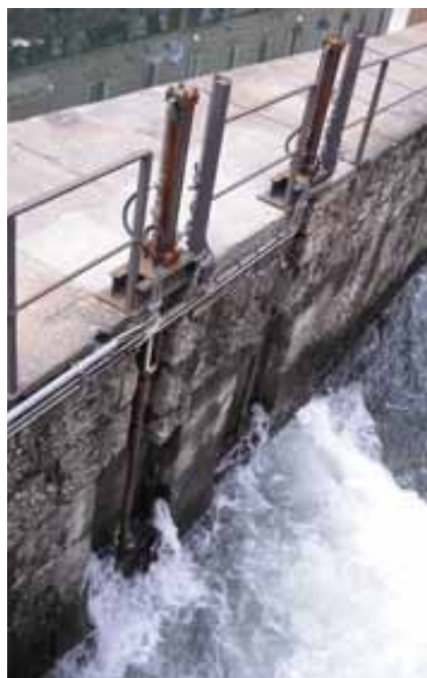
Impianto mini idroelettrico, Comune di Milano
